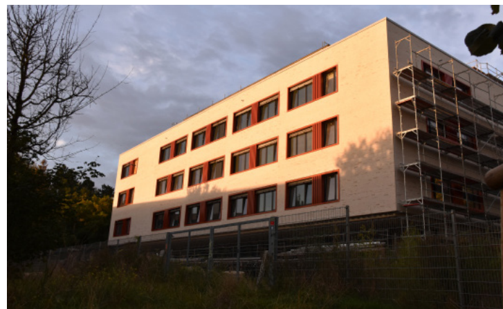
Die Fassade kommt mit dem Rückbau des Gerüsts Schritt für Schritt zum Vorschein.
